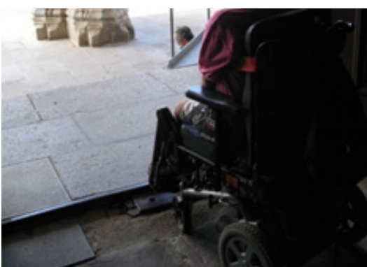
Rebordo de difícil acesso ao sair da Igreja .
